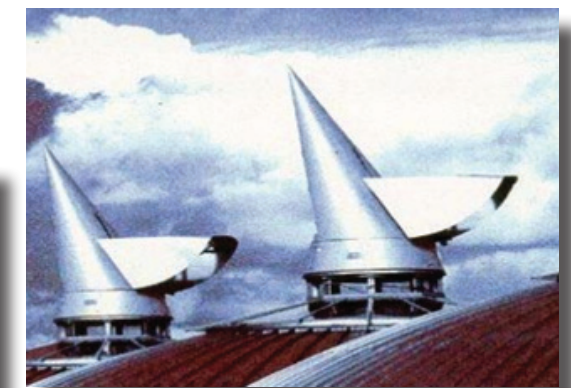
Şekil 6: Bluewater Alışveriş merkezi rüzgâr kapanları [4]
